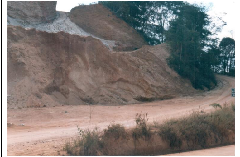
Figura 19- Encosta Impactada em Domingos Martins.
