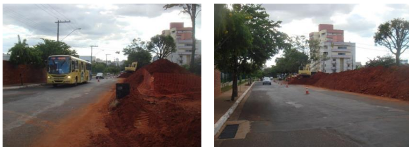
Figuras 1 e 2 – Uberlândia (MG): transtornos causados pelas obras na implantação do Corredor Estrutural Leste, 2016.
