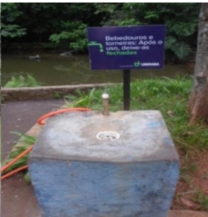
Figura 4- Bebedouro em mal estado de conservação na Mata do Ipê Foto: Autor (2016).
