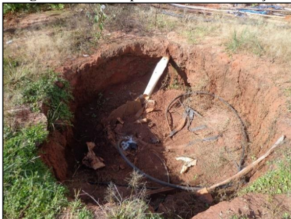
Figura 6: Fossa séptica em má conservação
